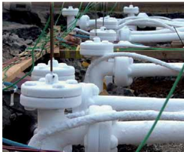
Installation de givrage au sol en cours de fonctionnement
