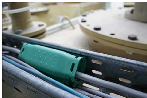
Gel-Kabelgarnitur Relifix V als Kabelverbindung.
