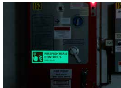
Segnaletica di sicurezza
