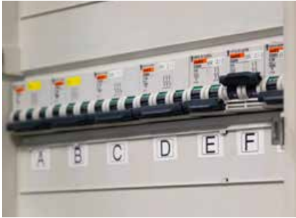
Kennzeichnung von Schutzschaltern
