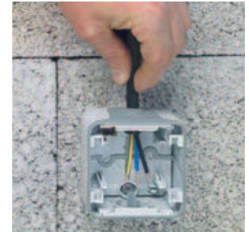
3/ La membrane de l'embout assure l'IP 55 de l'installation.
