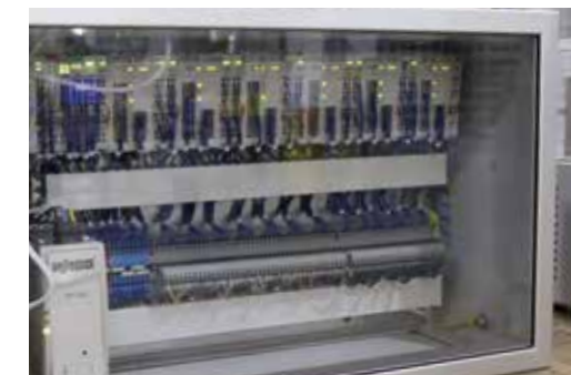
Schaltkasten mit WAGO Steuerung Control box with WAGO control unit
