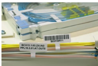
Kennzeichnungen von Glasfaserkabeln
